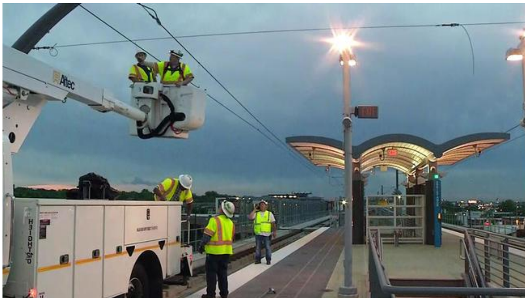
Figura 3-62: Equipos trabajan para reparar la línea ferroviaria de DART de Carrollton dañada por relámpagos. 345
