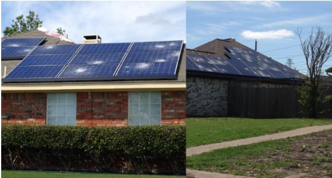
Figura 3-46: Daños por granizo a paneles solares residenciales. 216
