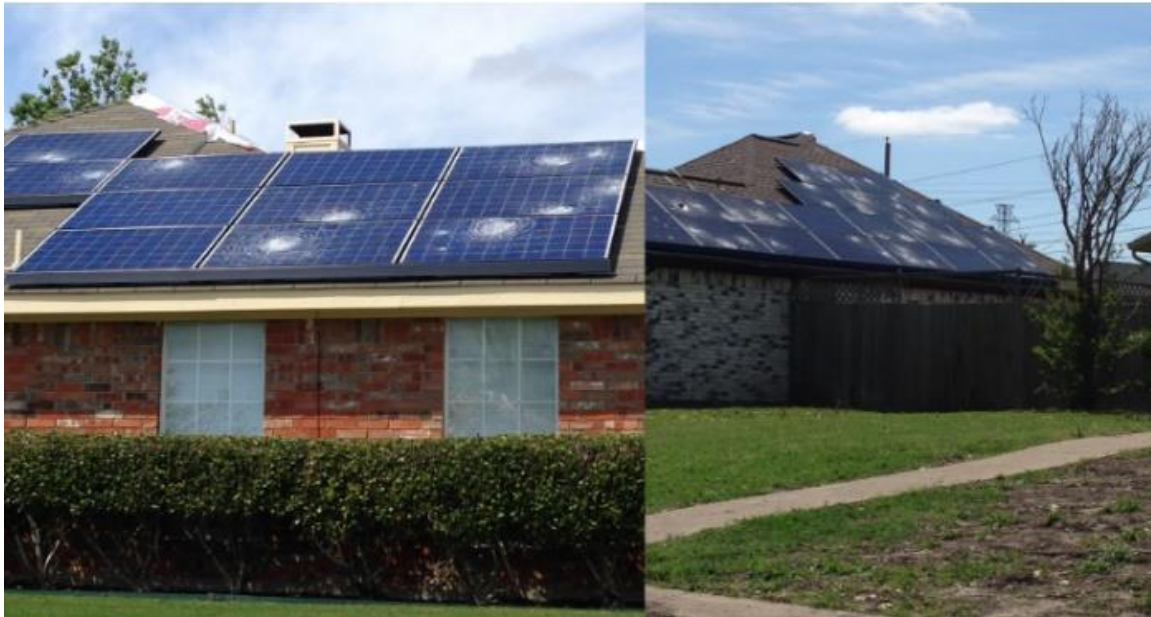
图 2-44: 冰雹损坏住宅的太阳能电池板。 212
