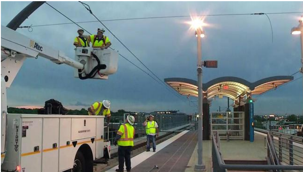
图 2-60: 工作人员正在维修被闪电损坏的卡罗尔顿 DART 站铁路。 341
