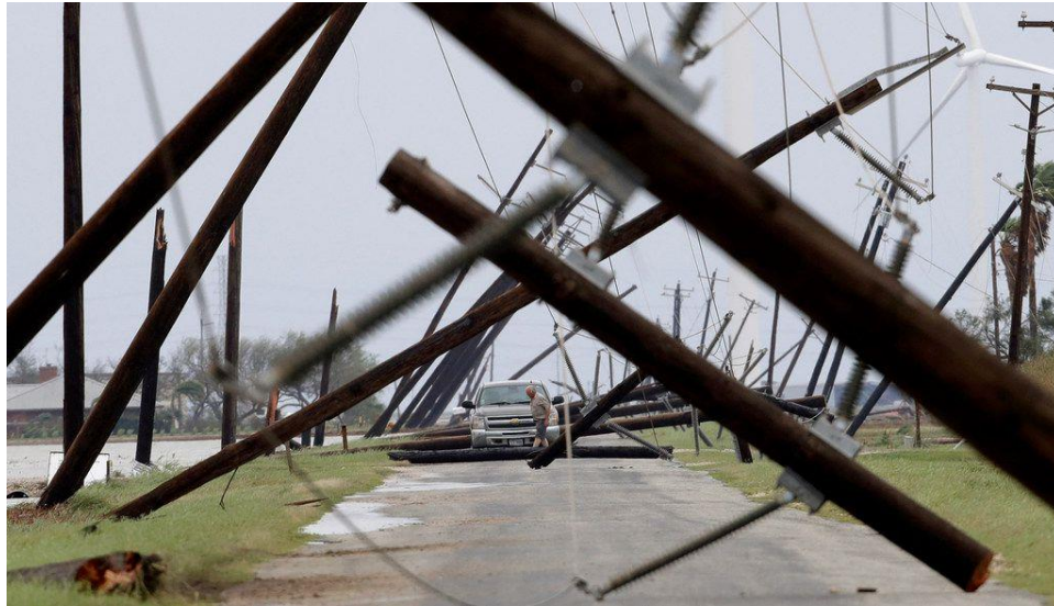
Hình 2-30: Hệ thống đường dây bị đứt sập gần Taft, Texas, trong Siêu bão Harvey. 122
