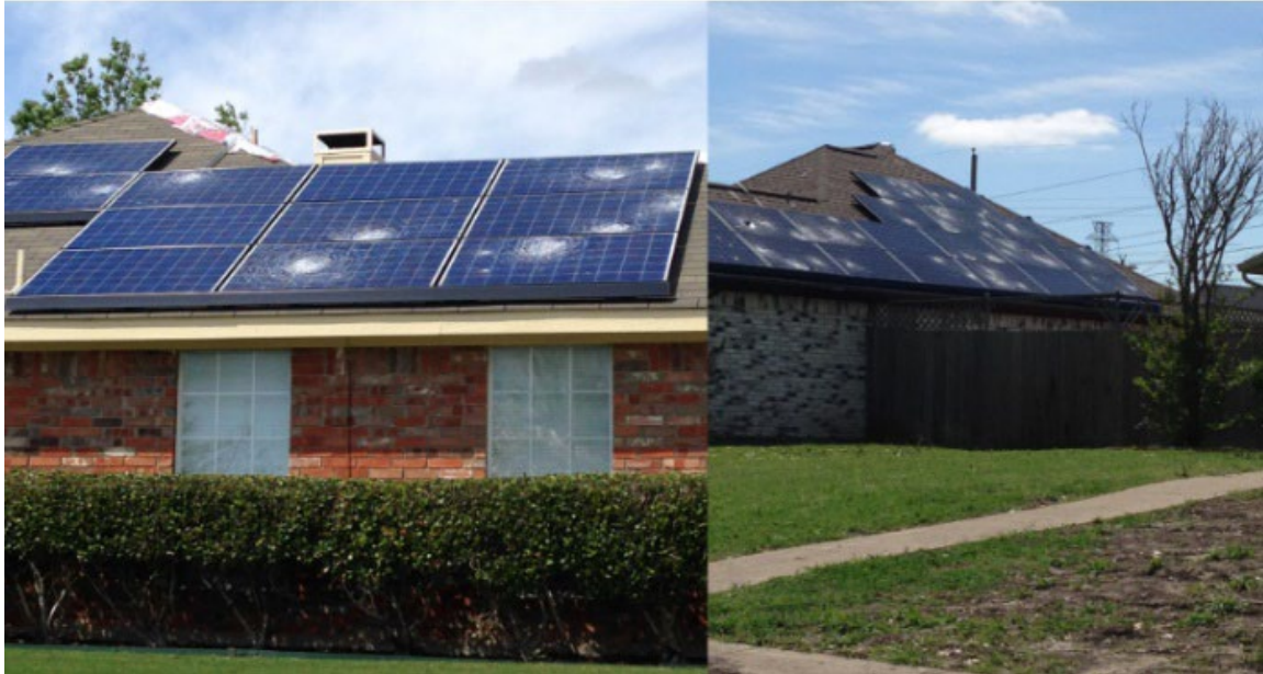
图 3-36: 冰雹损坏住宅的太阳能电池板。 216
