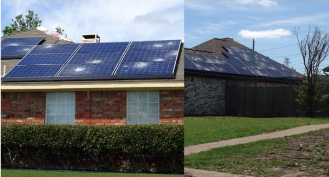
Figura 3-46: Daños por granizo a paneles solares residenciales. 216
